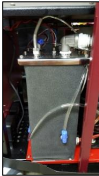
Tanque de agua
