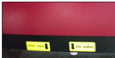
Válvula de drenado | Valvula de aire
